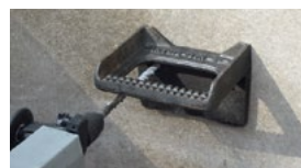
5. Vyvrtajte a vyčistíte druhý vyvrtaný otvor. Nášľap slúži ako šablóna na vrtanie
